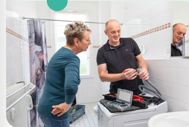
Schnelle Hilfe, wenn der Wasserhahn mal tropft. Der technische Dienst ist umgehend zur Stelle.
